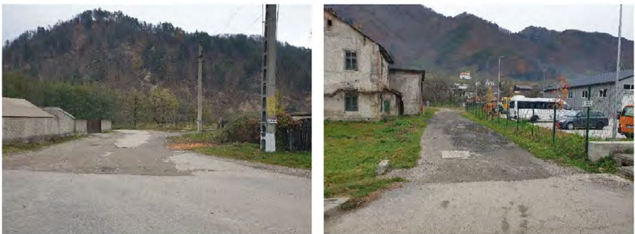
Figura 2.33. Străzi nemodernizate/ în stare tehnică necorespunzătoare (exemplificare).
